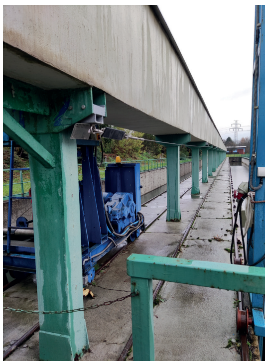
fot. 1. Lina zabezpieczająca wzdłuż długiego zbiornika.
